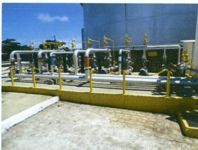
Figura 11 – Parque de Bombas
