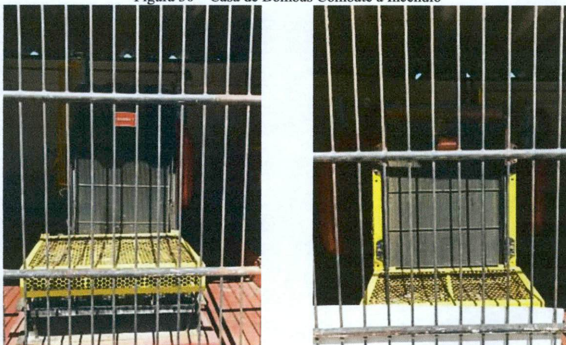
Figura 30 – Casa de Bombas Combate a Incendio
