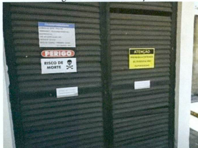
Figura 23 – Casa de Força
