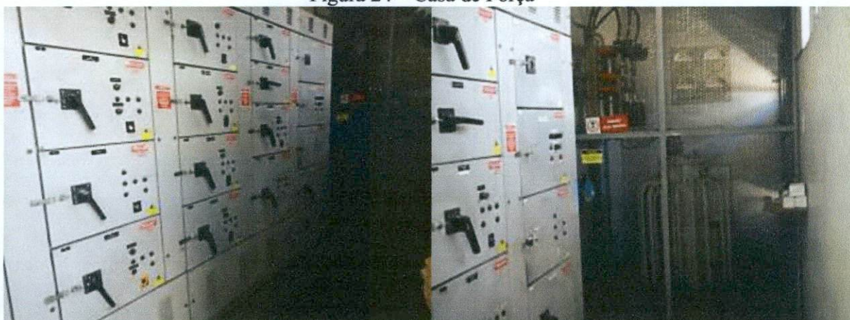
Figura 24 – Casa de Força
